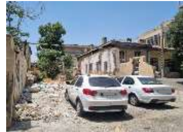
شکل ۸- نمایی از خانه‌های تخلیه شده در محدوده پلاک ثبتی دانشگاه پس از اجرای حکم قلع و قمع-نگارندگان، ۱۴۰۴
